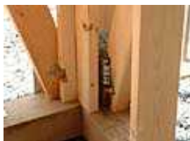
ホールダウン金物 基礎と構造躯体を緊結
